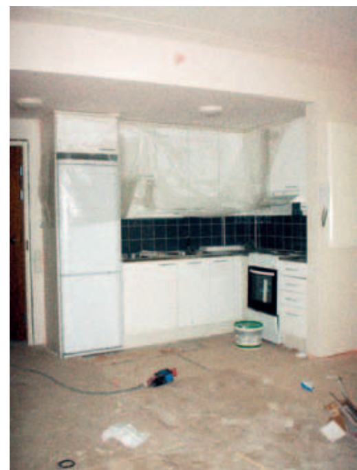
Aleksanterinkaari 6:ssä jo yhdessä asunnossa paikoillaan oleva mallikeittiö näyttää suuntaa alkuvuodesta käynnistyville kalusteasennuksille.
